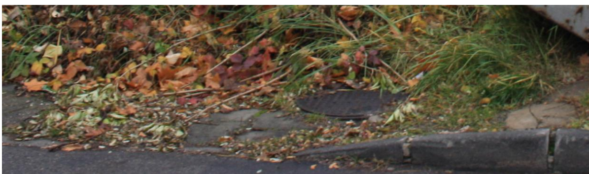
graf. 118 Studnia kanalizacyjna w istniejącym pieszym trakcie komunikacyjnym, źródło: zasoby własne
