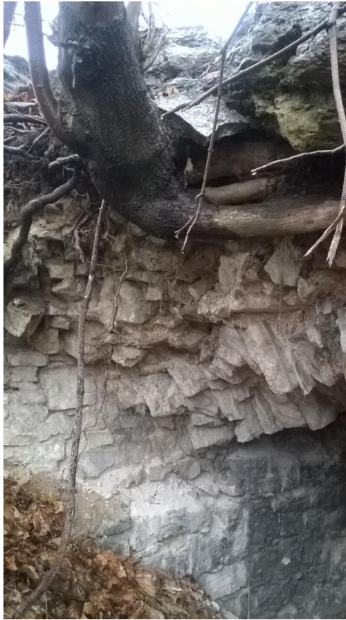
Fot. 8 – brama zachodnia do K1 – oparcie sklepienia łukowego od strony północnej – drzewo generujące obciążenie sklepienia momentami zginającymi – widoczne nieregularne ułożenie kamieni w górnej części sklepienia spowodowane obciążeniami zmiennymi i rozporem ukorzeniającego się drzewa. Widoczne ubytki sklepienia, które podpierano wcześniej pień drzewa a obecnie uległo degradacji.
