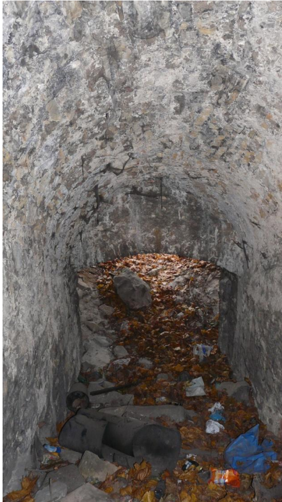
Fot. 3 – fragment korytarza spadkowego K1 z bramą zachodnią. Sklepienie nie wykazuje wypłukiwania mleczka wapiennego z uwagi na dość duży spadek podłużny sklepienia.
