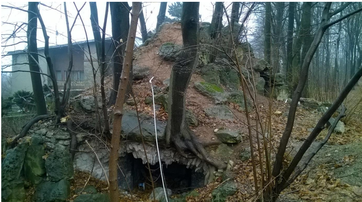
Fot. 6 – Brama zachodnia do K1 od strony zewnętrznej – widoczne ubytki sklepienia łukowego oraz drzewo niszczące korzeniami sklepienie.
