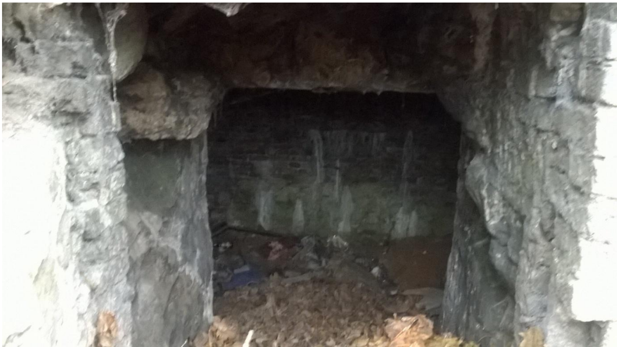
Fot. 12 – Wejście do komory K2 z perspektywą wnętrza komory – widoczne zacieki wapienne z wody przesączającej się przez zaprawę ściany komory.
