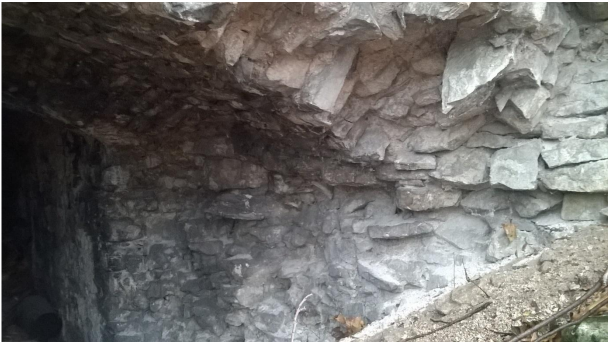
Fot. 10 – brama zachodnia do K1 – ubytki sklepienia oraz podpory południowej.
