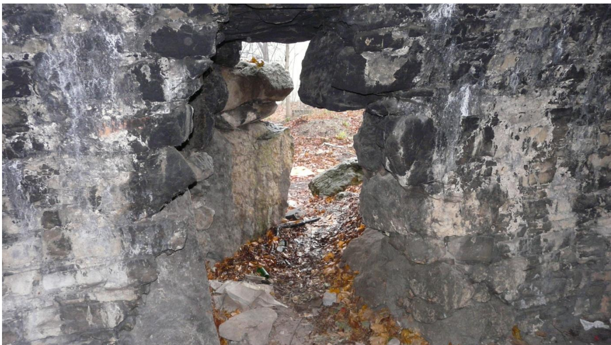
Fot. 4 – ubytki w oparciu elementów stanowiących wejście do groty K1 od południa (od strony szpitala).
