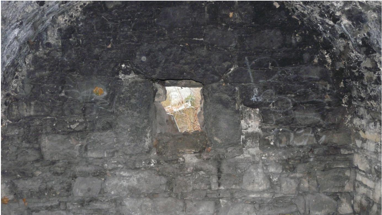
Fot. 1 – Widok na ścianę wschodnią wnętrza komory K1 – widoczne zacieki wapienne na sklepieniu łukowym pochodzące od wypłukiwania zaprawy ze sklepienia.
