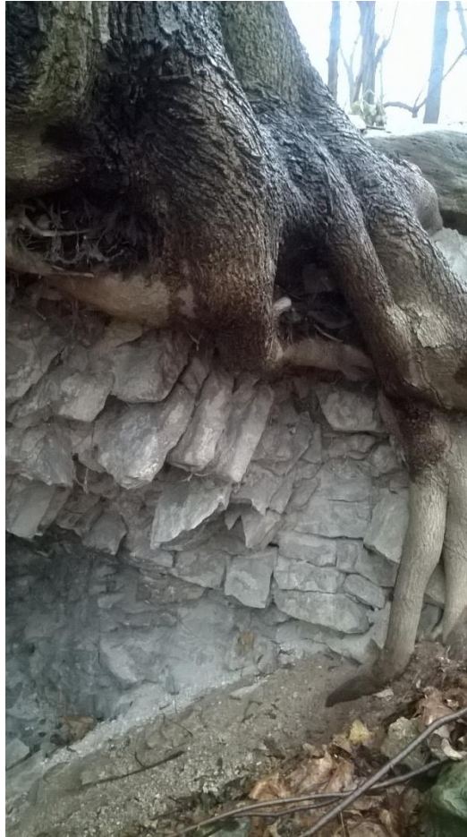
Fot. 7 – Brama zachodnia do K1 – oparcie sklepienia po stronie południowej – korzeń i obciążenia od drzewa spowodowały wykruszenie zaprawy – ta część wymaga niezwłocznej interwencji i w ocenie opracowującego grozi zawaleniem.
