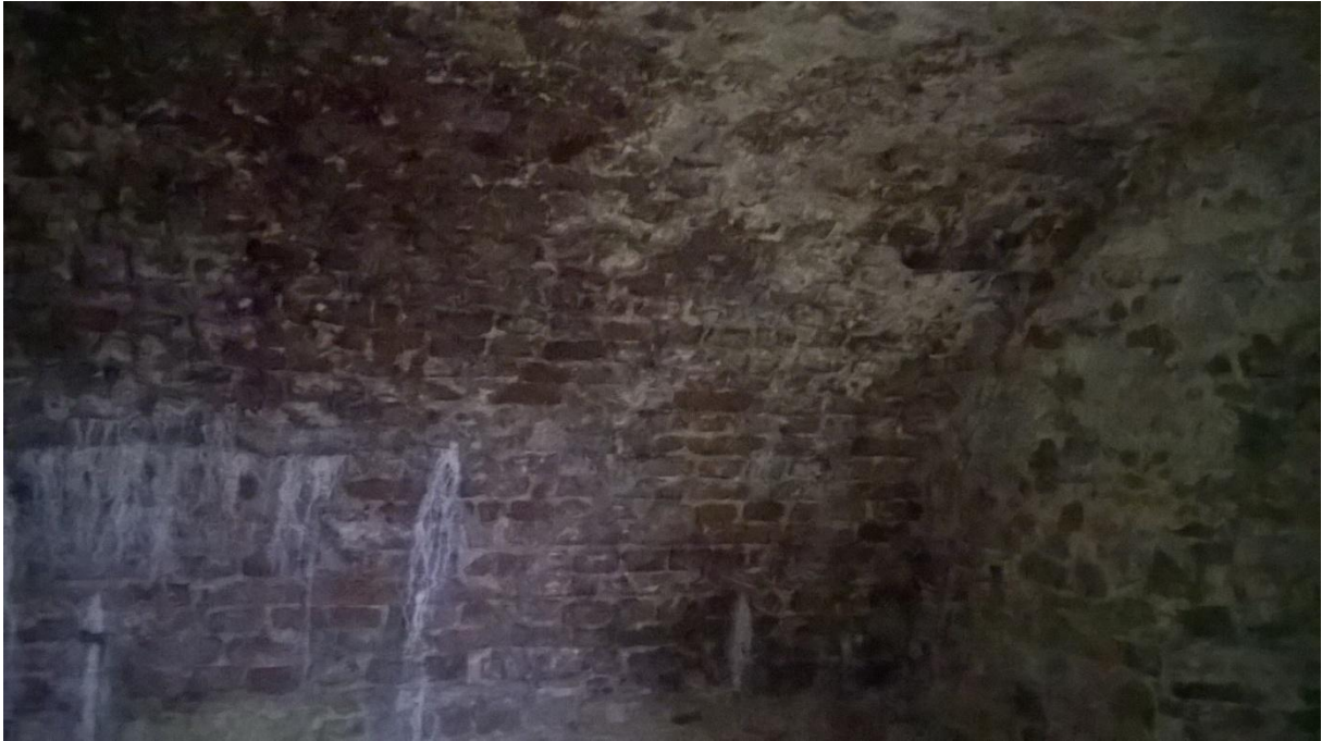
Fot. 13 – Wnętrze komory K2 – ściana i fragment sklepienia – widok w stronę północno – wschodnią. Widoczne zacieki wapienne.
